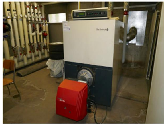
Photo 6 : installations techniques au sous-sol
